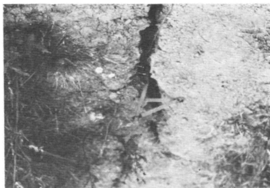
Foto 4. Detail exikačnej trhliny vytvorenej v letných mesiacoch 1978. Dĺžka trhliny 30 m, šírka 5—15 cm, otvorená hĺbka 20—45 cm
