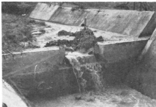
Foto 2. Akumulačná časť merného objektu zaplnená splavenou zeminou pri letnej búrke 16. 6. 1979
